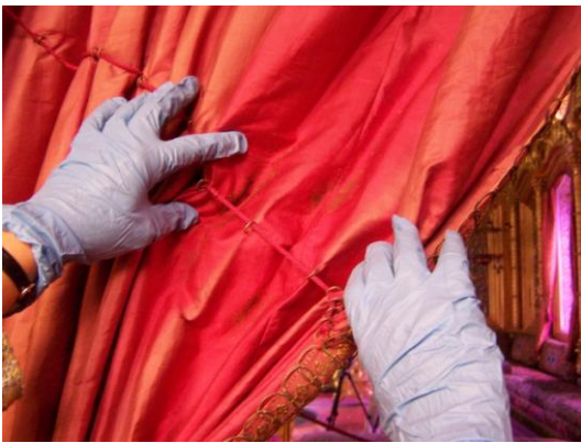
Bild 1: Inaktiver Schimmelbefall an der Draperie im Türkischen Saal im Königshaus am Schachen © Fraunhofer IBP
